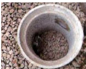
雨水浸透ます
