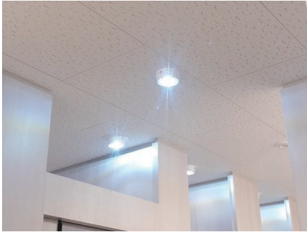
【図20-2】 光警報装置トイレ内設置の例
