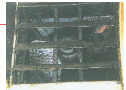
換気扇のダンパーが閉まらない!
