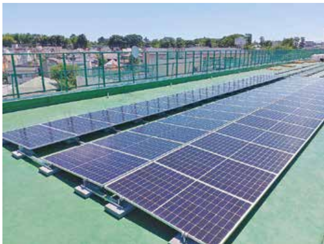
中学校の屋上に設置された太陽光パネル
