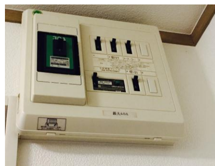
↑電気ブレーカーの例
