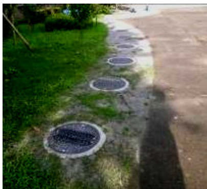
災害用マンホールトイレ
