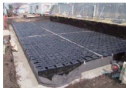
雨水貯留施設の例
