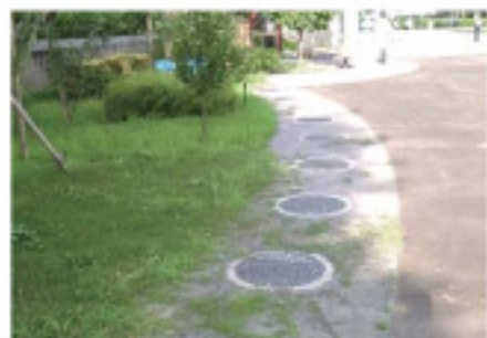
災害用マンホールトイレ
