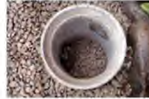
雨水浸透ます
