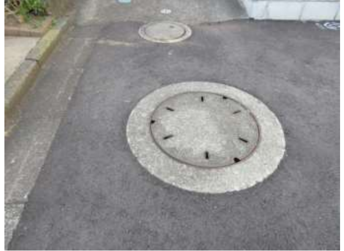
下水道マンホール（私道） マーク無し
