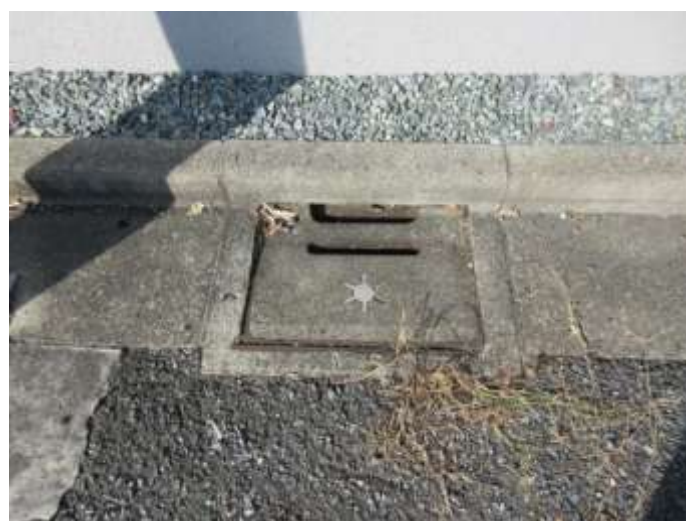
道路雨水枡（私道） マーク塗りつぶし
