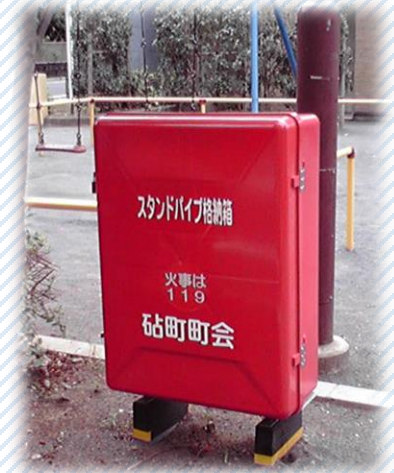
▲スタンドパイプ収納箱（三峰公園）
