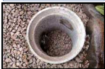
雨水浸透ます
