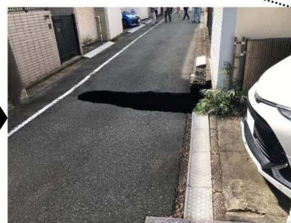
10月18日12:30(陥没発生)
