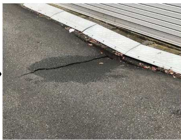
10月18日11:50(舗装亀裂)
