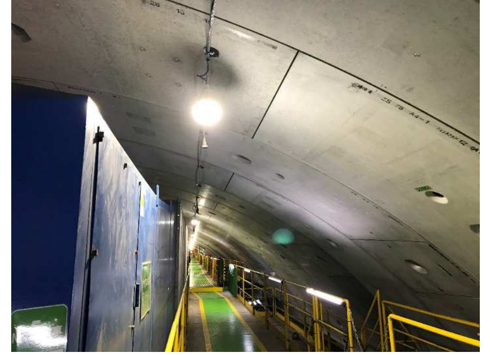
写真3 坑内状況写真(空洞発見箇所付近右側)
