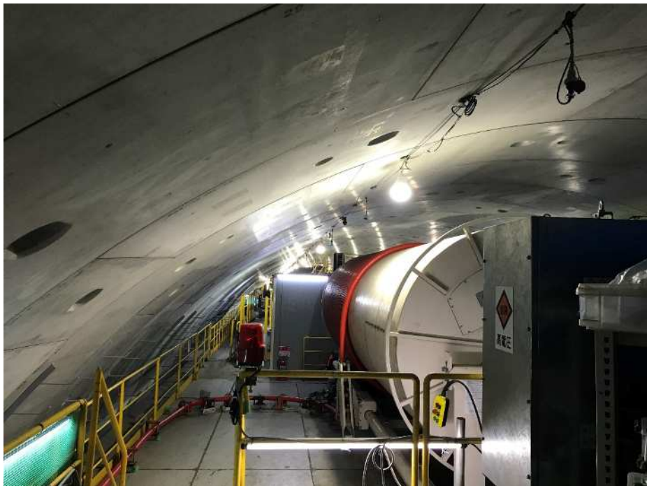
写真4 坑内状況写真(空洞発見箇所付近左側)
