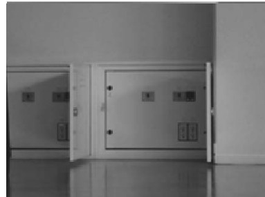
体育館内の非常用コンセント
