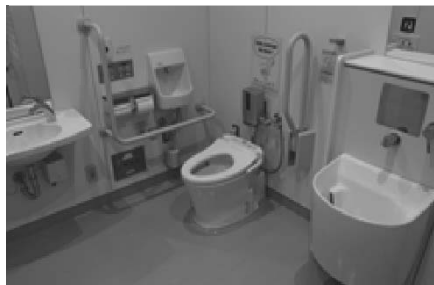
1階の災害時対応トイレ
