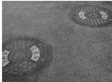
マンホールトイレ
