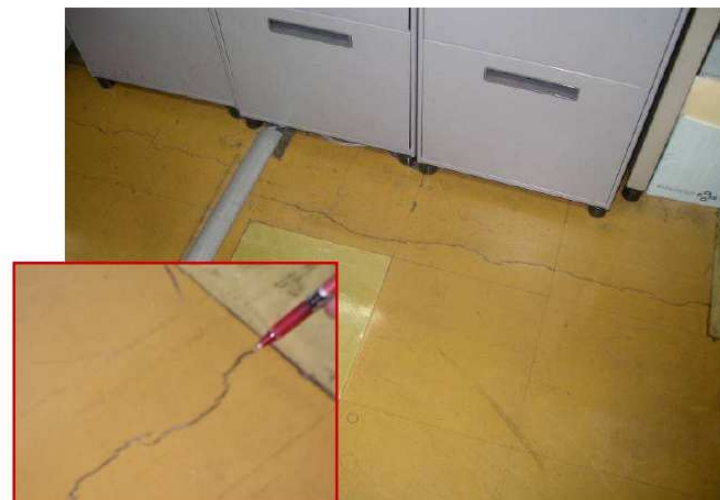
床のクラック(ひび割れ)(第1庁舎)
