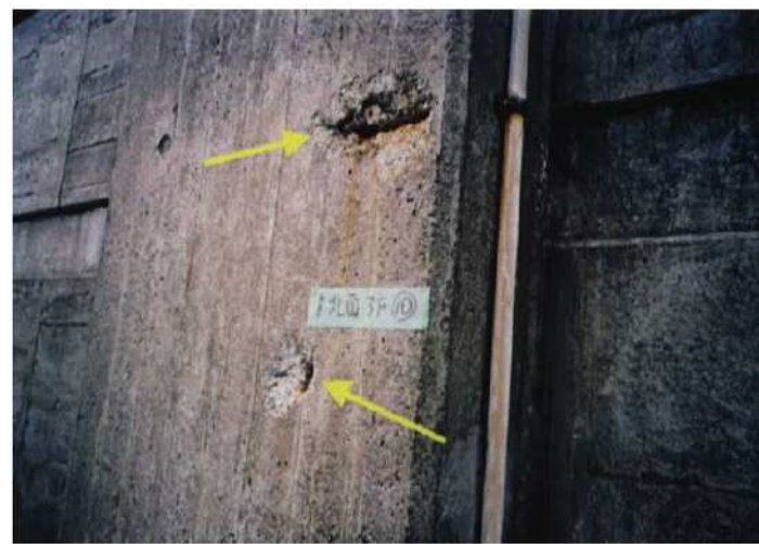
外壁の劣化(第1庁舎)
