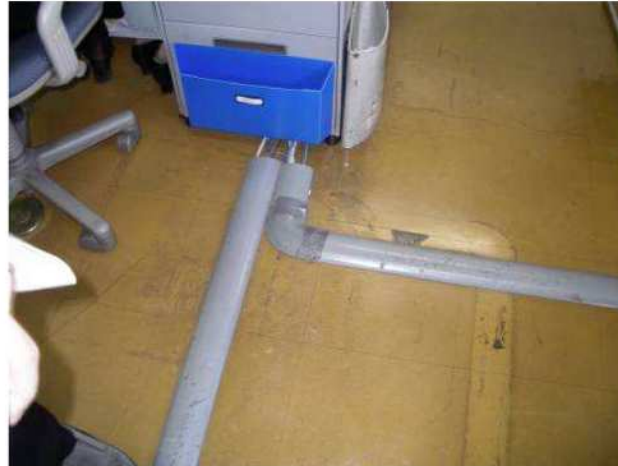
床に露出した配線(第1庁舎)
