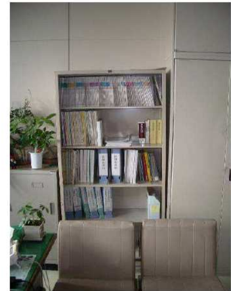
床段差によるキャビネット傾き(第2庁舎)
