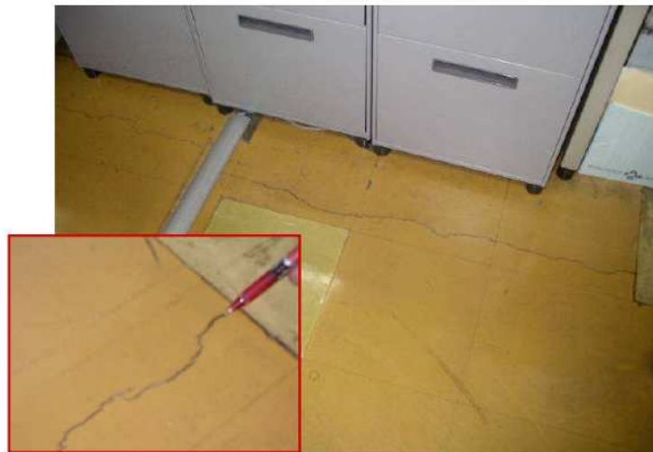
床のクラック(ひび割れ)(第1庁舎)
