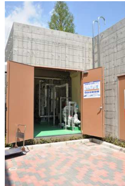
地下水利用システム出入口
