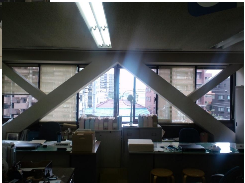
耐震ブレースの例
