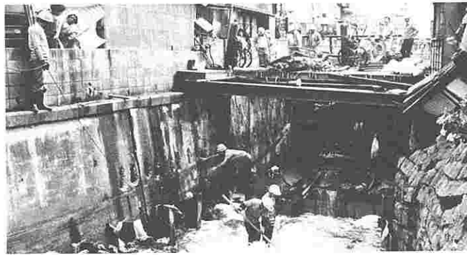
被害が出た北沢川梅丘付近下水道工事現場。
