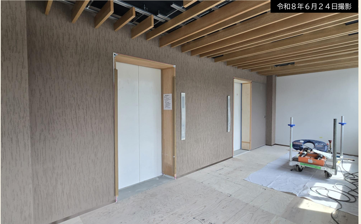
2階エレベーターホールの様子。西2期棟に設置するエレベーター(左側)は、火災時には、消防隊による消火・救助に活用される「非常用エレベーター」仕様としています。
