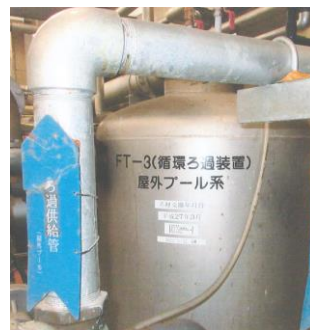
設備の老朽化(3)
