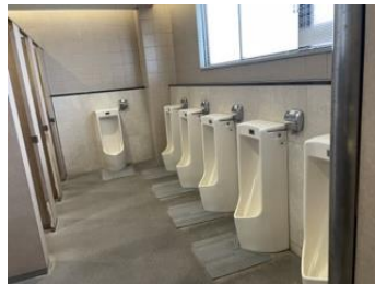
トイレの手すり未整備
