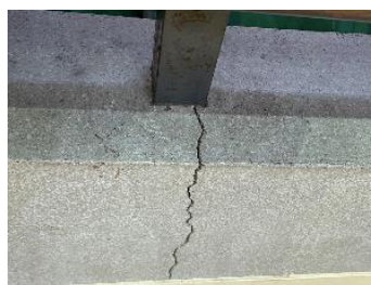
外壁等のひび割れ(3)
