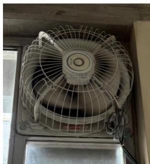
設備の老朽化(1)
