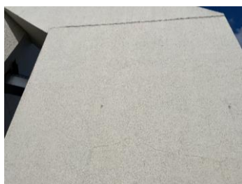
外壁等のひび割れ(1)
