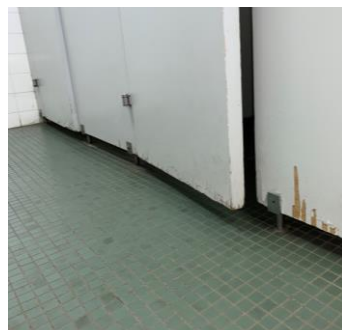
設備の老朽化(2)
