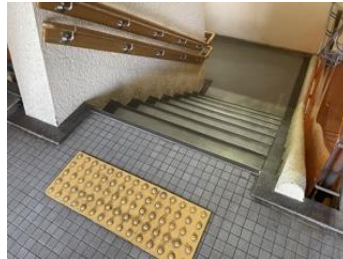
踊り場の両側に手すりなし
