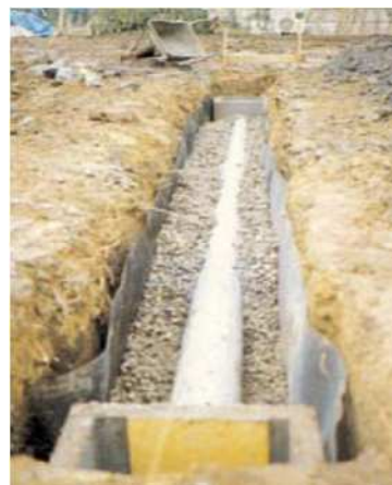
雨水浸透トレンチ
