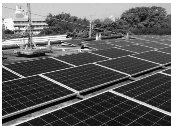
(b) 屋根貸し事業で設置した太陽光パネル
