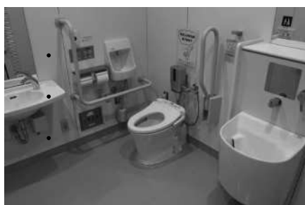
▲ 1階の災害時対応トイレ
