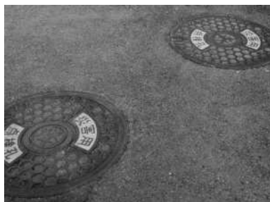
▲ マンホールトイレ
