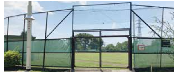
〔現状〕老朽化し、高さも十分でないフェンス
