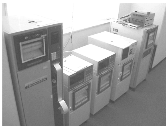
砧大気汚染常時測定室
