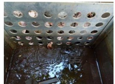
堰内の調整水が全て無い (令和8年1月30日)
