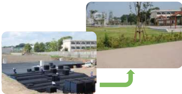
広場の地下に埋設されている雨水貯留施設(二子玉川公園)
