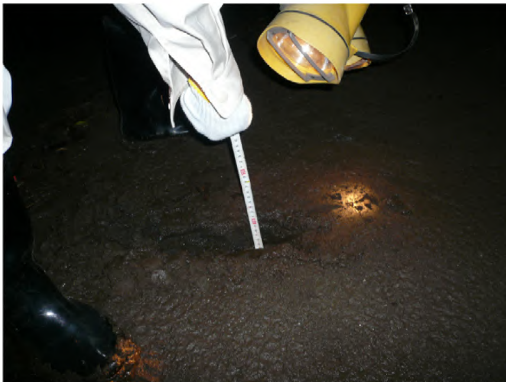
図 7.1 地下貯留槽に貯まった土砂
