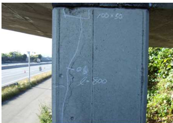
ひびわれ（橋脚）
