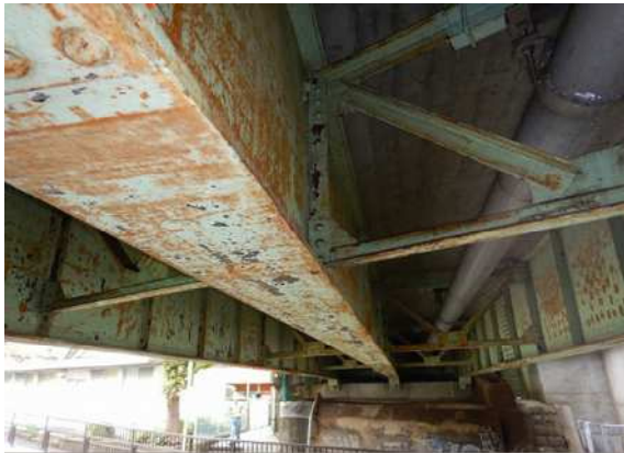
塗装劣化（主桁）
