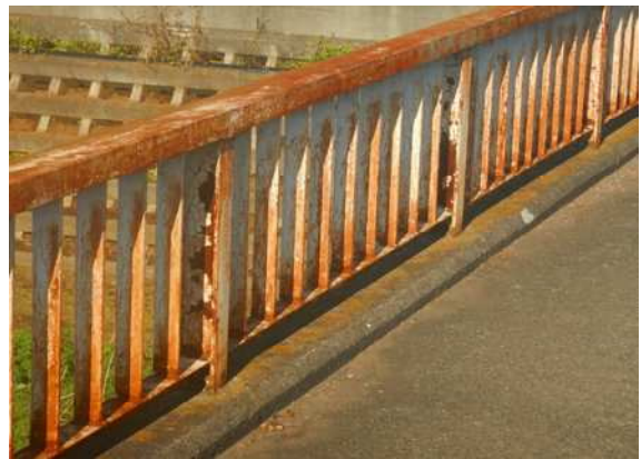
塗装劣化（高欄）
