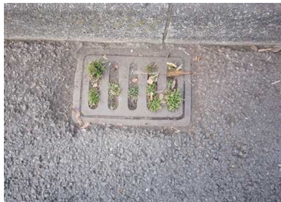
土砂詰り（排水ます）
