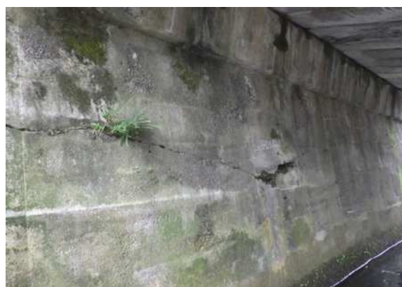
ひびわれ（橋台）
