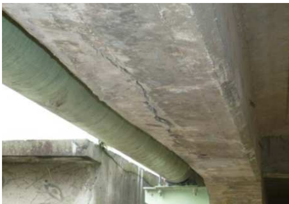
ひびわれ（主桁）
