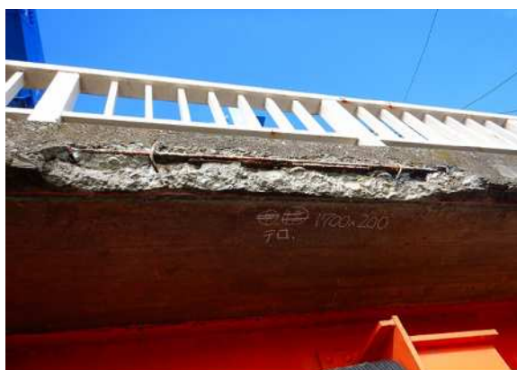
剥離・鉄筋露出（地覆）
