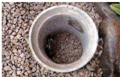
雨水浸透ます
