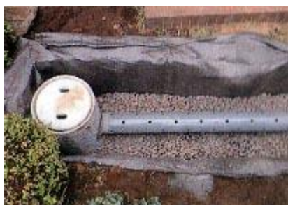
浸透(トレンチ)管
