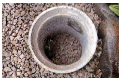
雨水浸透ます
