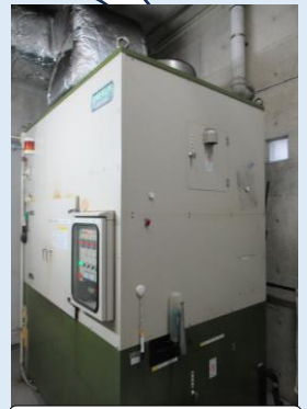
▲乾熱滅菌減量処理装置
