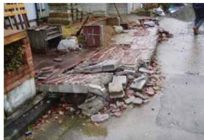
倒壊した塀 (大分市HP)
