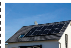
太陽光パネル
