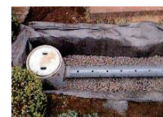
浸透(トレンチ)管
