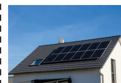
太陽光パネル
