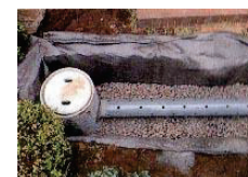
浸透(トレンチ)管
