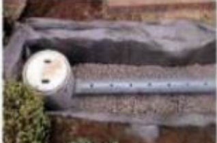
浸透トレンチ管
