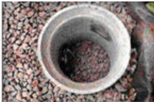
雨水浸透ます
