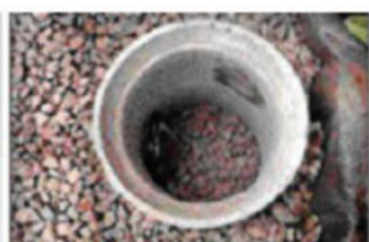
雨水浸透ます
