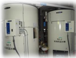
ボイラ（ガス式）
