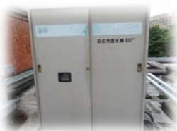
吸収式冷温水機
