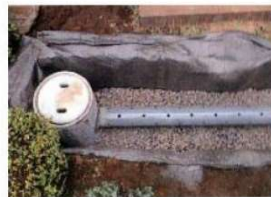
浸透(トレンチ)管
