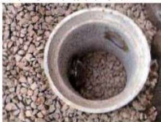
雨水浸透ます
