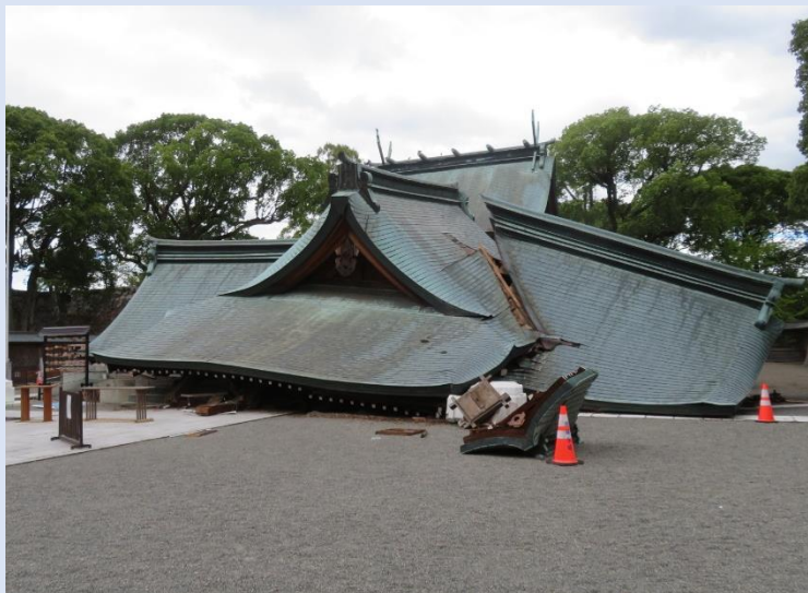
倒壊した八代宮拝殿（八代市）
