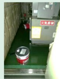
地下EV機械室が 水没した様子
