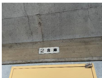
外壁等のひび割れ(2)
