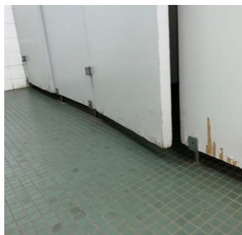
設備の老朽化(2)
