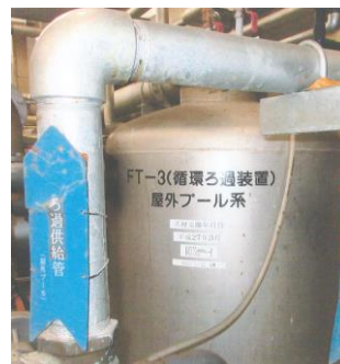
設備の老朽化(3)
