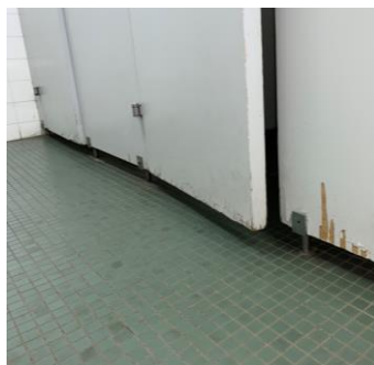
設備の老朽化(2)
