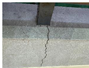
外壁等のひび割れ(3)
