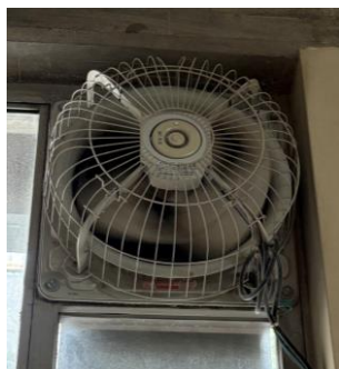
設備の老朽化(1)
