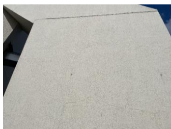
外壁等のひび割れ(1)
