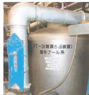
設備の老朽化(3)
