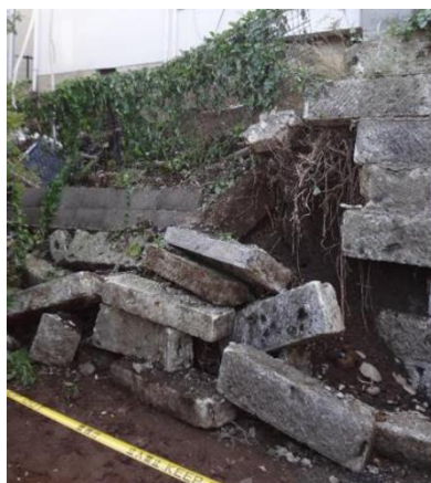
降雨による空石積み擁壁の崩壊 (玉川地域)
