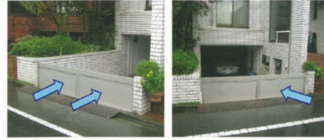
●地下駐車場には「止水板」の設置●
