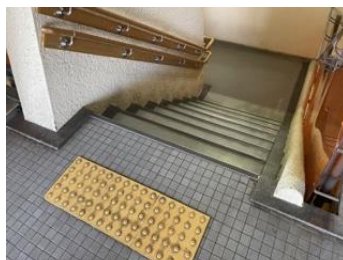
踊り場の両側に手すりなし
