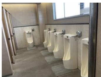
トイレの手すり未整備
