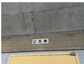
外壁等のひび割れ(2)
