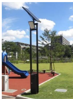
自然エネルギー照明灯
