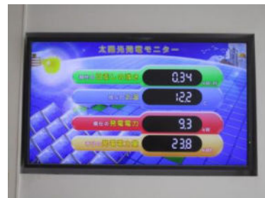
発電状況等モニターの例
