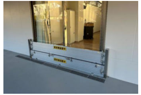
出入口に止水板を設けた例 (瀬田小学校)
