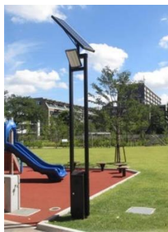
自然エネルギー照明灯
