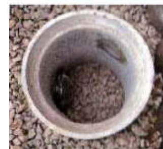
雨水浸透ます
