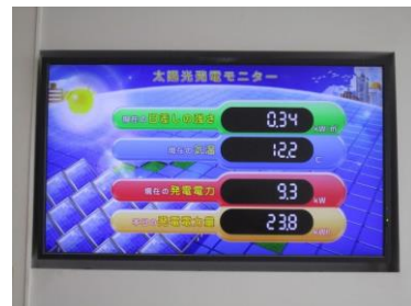
発電状況等モニターの例
