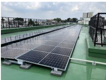
太陽光発電パネルの例
